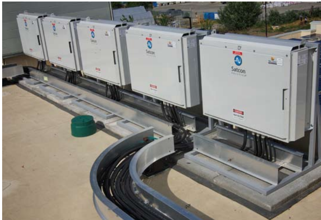
Des câbles à âme en cuivre reliés aux modules photovoltaïques servent à transporter le courant continu aux combineurs Satcon Solstice.
