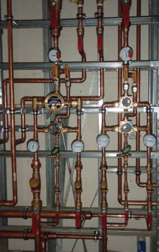
Cette photo montre bien la complexité des systèmes mécaniques.
