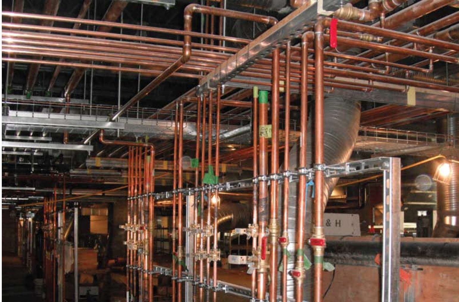
Pose soignée de tubes de cuivre dans le plafond et des descentes verticales dans un espace intercalaire.
