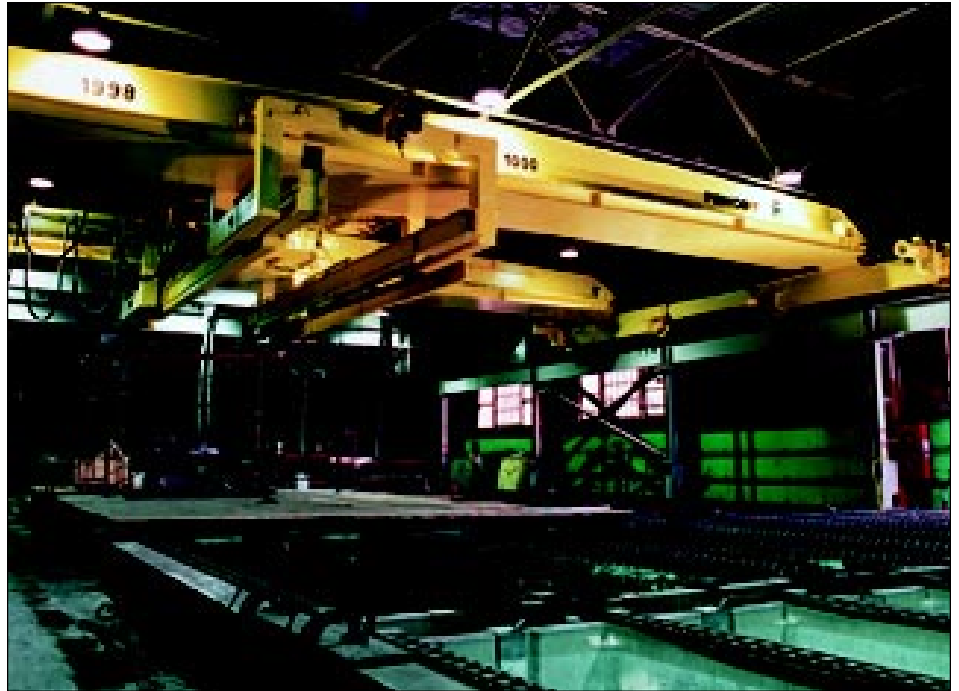
Des chariots de travée transportent les cathodes et les anodes jusqu'aux cuves électrolytiques.
