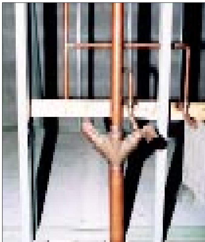
▲ Conduites de distribution et d'évacuation en cuivre pour éviers adossés habilement placées entre deux charpentes d'acier.
