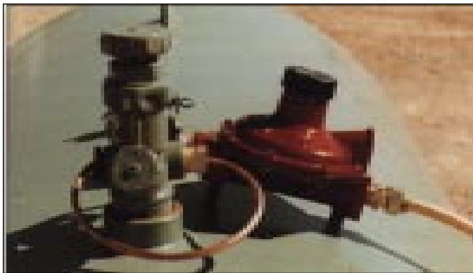
▲ Le tube en cuivre est utilisé depuis des décennies pour réaliser des systèmes de distribution de propane.
